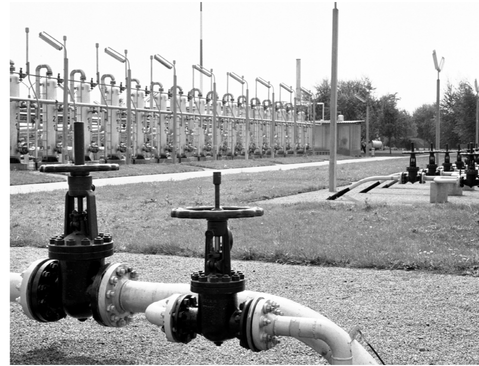
Sondenmanifold mit Filtern
